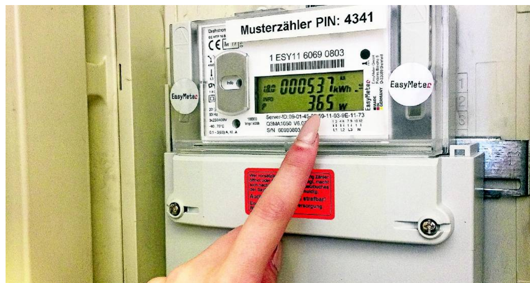
Neben dem Gesamtverbrauch zeigen die neuen Zähler auch den aktuellen Stromverbrauch an. Foto: Kneue
